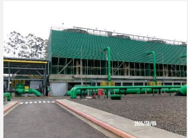
Torre de resfriamento do condensador.
