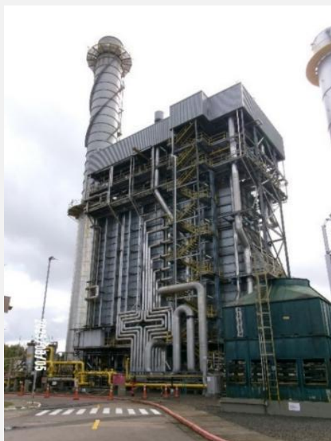
Vista lateral da caldeira de recuperação de calor.
