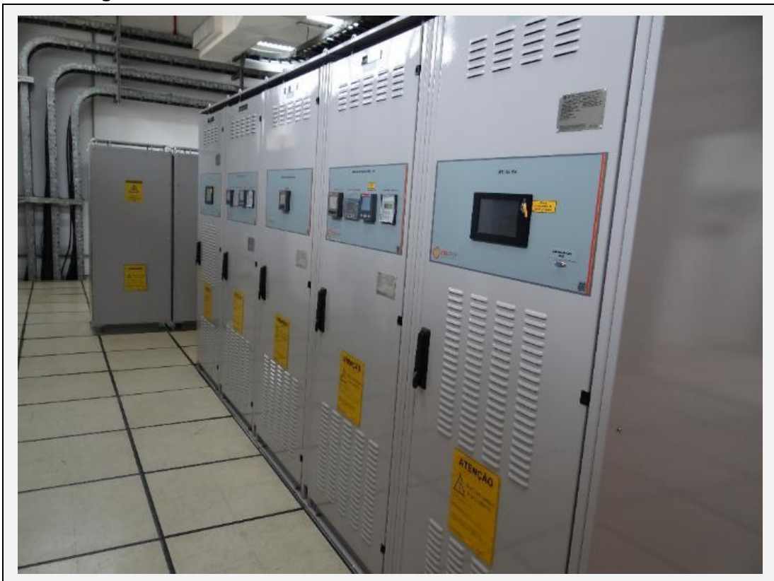
Figura 21 - Painéis novos dos sistemas de retificadores / UPS / Baterias.
