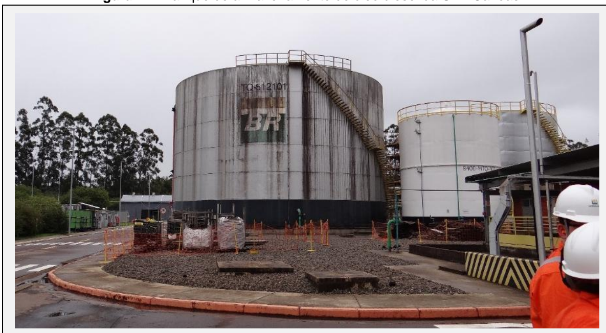
Figura 22 - Tanque de armazenamento de óleo diesel da UTE Canoas.
