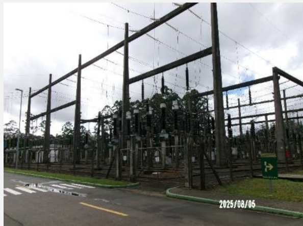
Subestação de conexão com o SIN.
