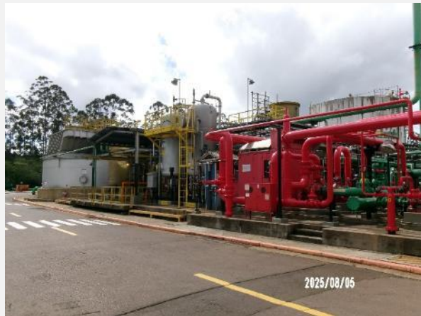
Sistema de combate a incêndio.
