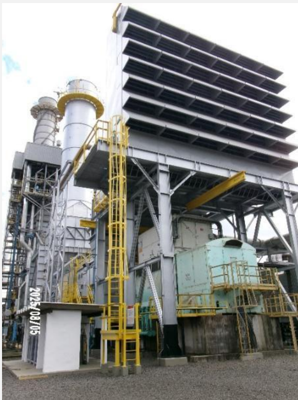
Casa de filtros da turbina a gás UG1.
