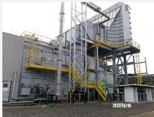
Vista lateral da turbina a gás.
