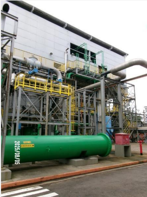
Entrada de água do condensador - Vista lateral da turbina a Vapor.
