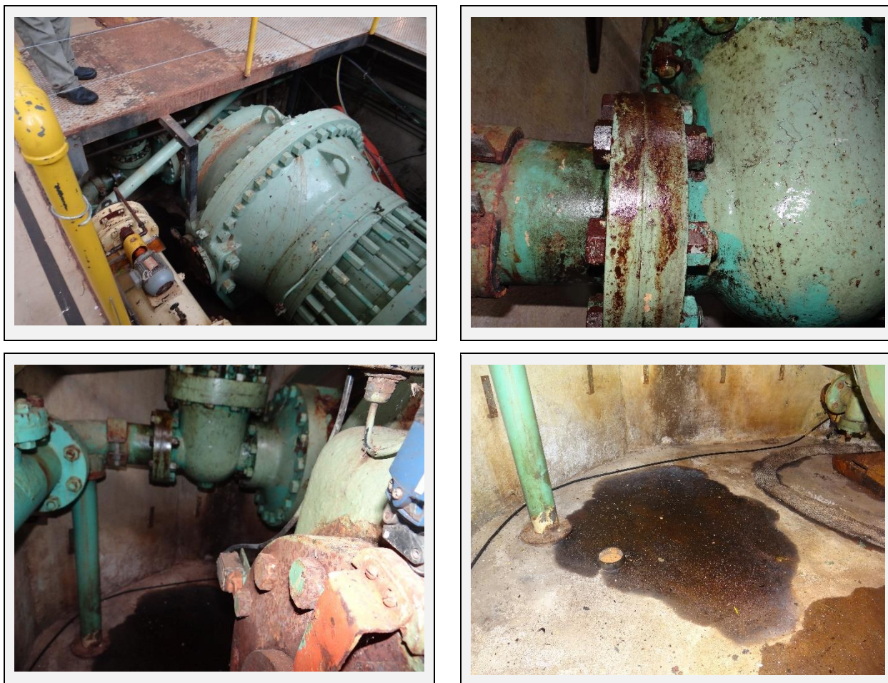
Figura 13 - Vazamento de óleo no sistema hidráulico da unidade geradora da UHE Bugres.
