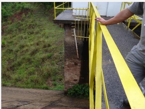
Réguas graduadas de nível d'água desalinhadas.
