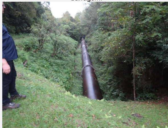
Conduto adutor da UHE Canastra no trecho próximo à barragem.
