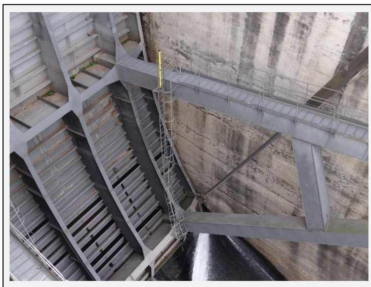
Figura 38 - Escada tipo marinheiro de acesso aos painéis da comporta vertedouro danificada.
