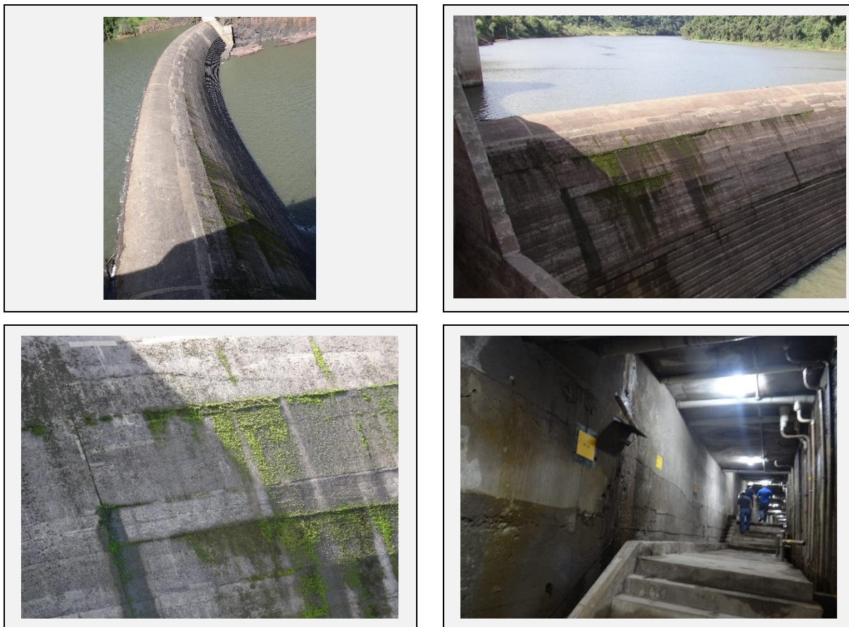
Figura 25 - Registros fotográficos da barragem de UHE Monte Claro - presença de trilhas de umidade e musgo em áreas do paramento a jusante da barragem e galeria de drenagem.
