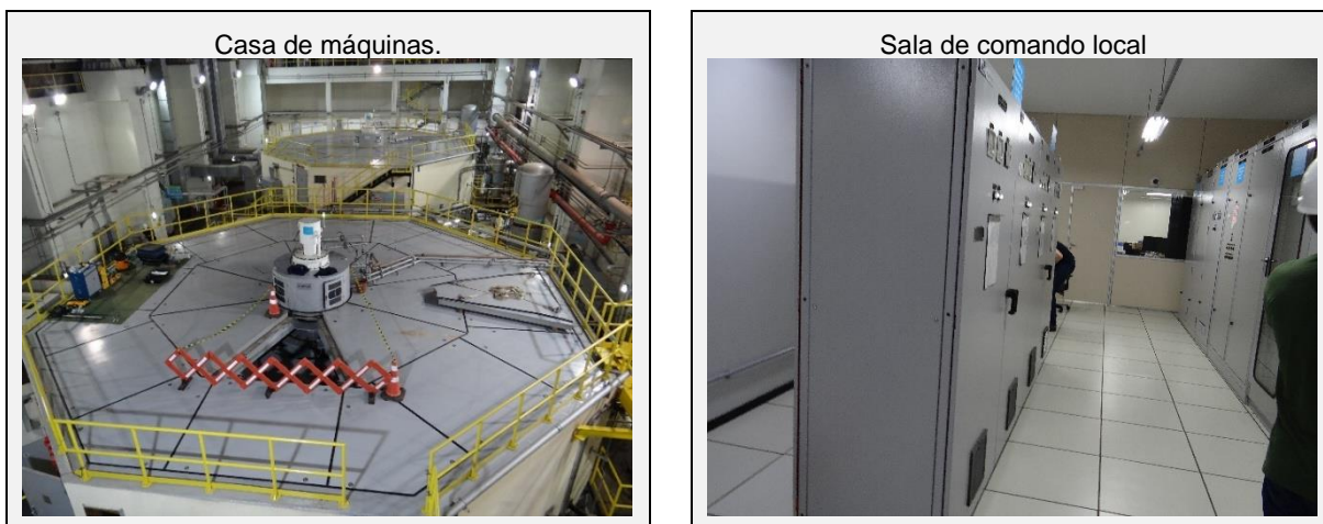
Figura 34 - Casa de máquinas da UHQJ - Registro fotográfico realizado em 22/04/2025.
