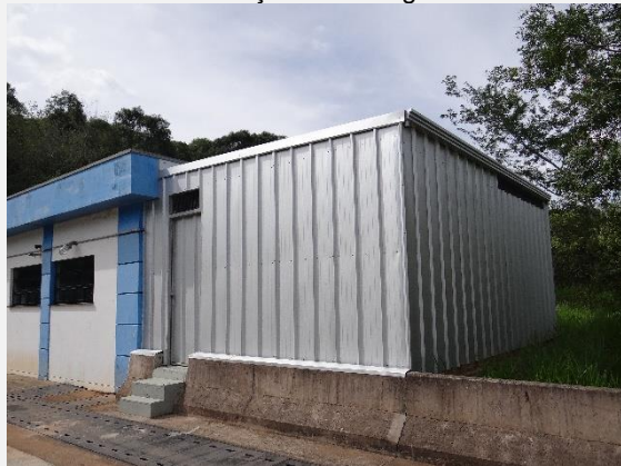
Abrigo instalado para o gerador diesel da alimentação de emergência
