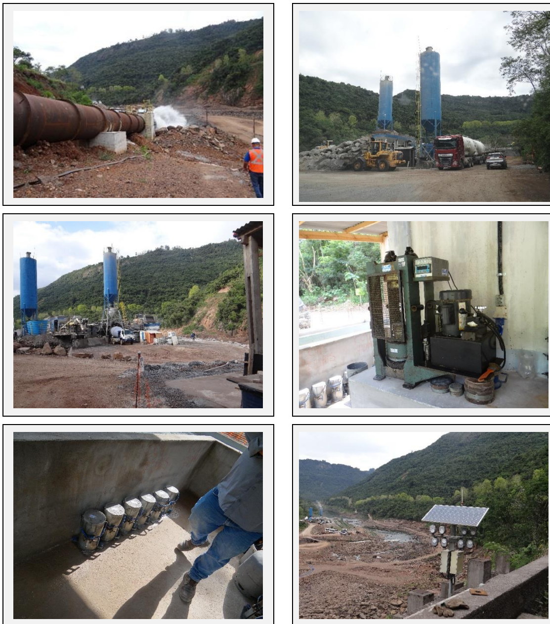
Figura 12 (cont.) - Conduto forçado, usina de concreto, laboratório de concreto e sistema de alerta na UHE Castro Alves.
