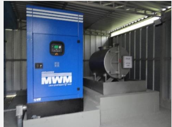
Alimentação de emergência dos serviços auxiliares - Gerador diesel.
